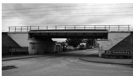
Fot. 3. Wiadukt kolejowy nad drogą wojewódzką 182 we Wronkach, widok na północny wschód (fot. Bartosz Ławrynowicz)
